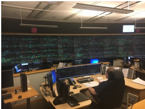
Figur 16. Trafikledningscentralen i Malmö.
